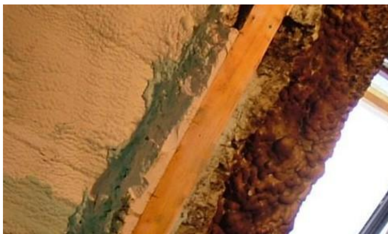
Fot. 1 (Kumibex sp. z o.o.) – Pianka poliuretanowa po ataku ognia. Po prawej stronie zdjęcia widzimy powstałą zgorzelinę pod działaniem ognia i bardzo wysokiej temperatury na zewnętrznej warstwie pianki. Po lewej stronie widoczne fragmenty pianki po ściągnięciu warstwy zgorzeliny. Część warstw bezpośrednio pokrywających deskowanie, nie uległa uszkodzeniu.
